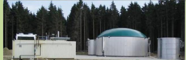
Fig 10 : Usine de cogénération de l'aéroport de Frankfurt Hahn présentant une cuve de pré stockage (en haut à gauche), une vue intérieur du digesteur (en haut à droite) et une vue extérieure globale de l'usine de méthanisation (en bas).
