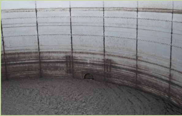
Fig 4 : vue intérieur d'une cuve en inox en cours de fonctionnement
